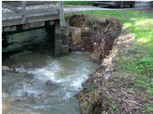
Bild: Unterspülung Gernitzbrücke
